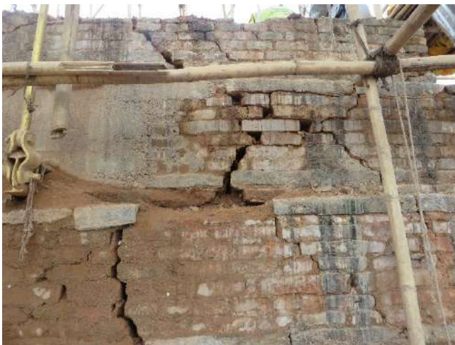
銅板撤去後のハルミカの破損部分
