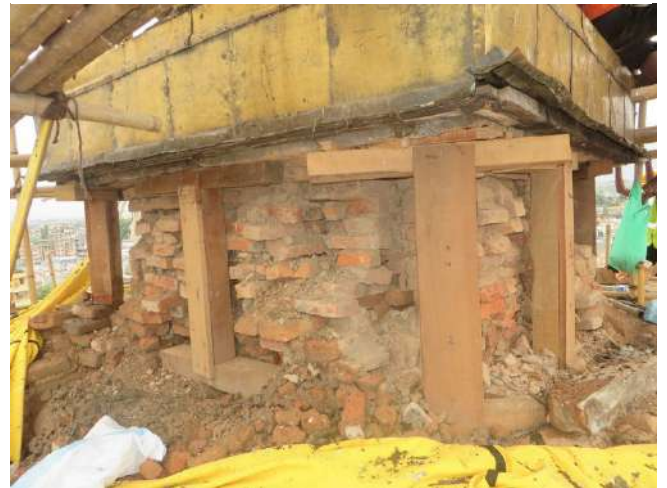
銅板撤去後新たに補強したハルミカの破損部分
