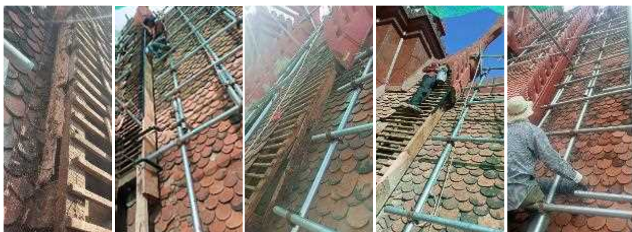
損傷した木材部材：修復前と修復後
