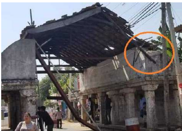
図5 破損した2019年のマダム
