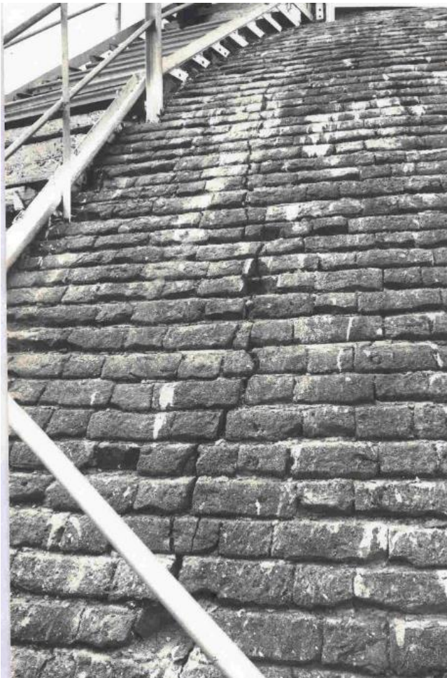
崩壊前のミリサウエティ仏塔ドーム上の亀裂
