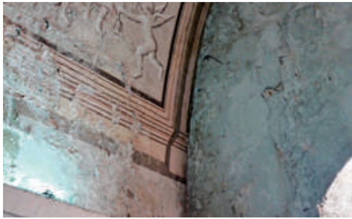
雨漏りで美しい壁画が剥がれている天井
