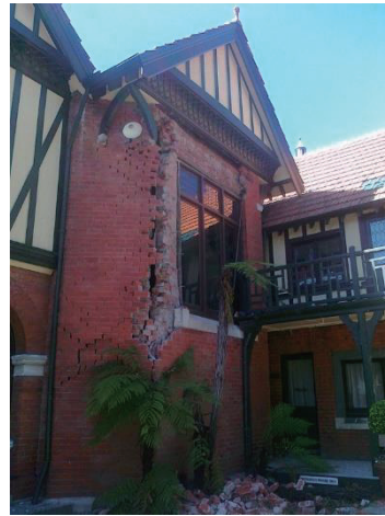
図 8. モナベール・ホームステッド、レンガ造りの外壁の損傷。写真：CCC 収蔵物
